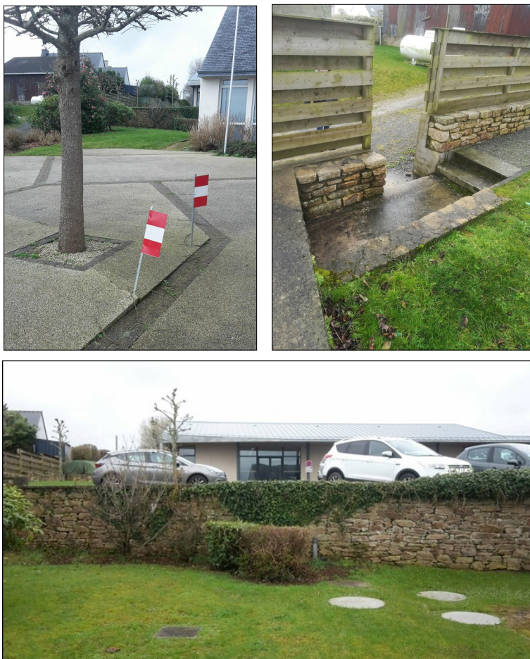
Figure 14 : Parvis endommagé et accès réduit à la salle polyvalente
